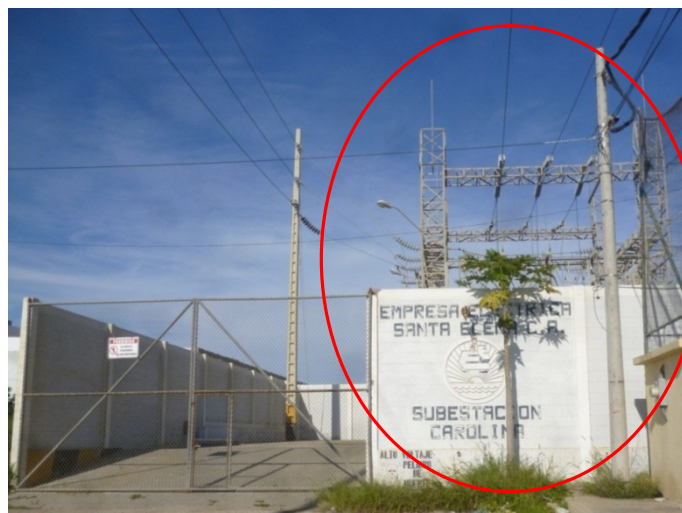
Fig 1.3 Pórtico de S/E Carolina
