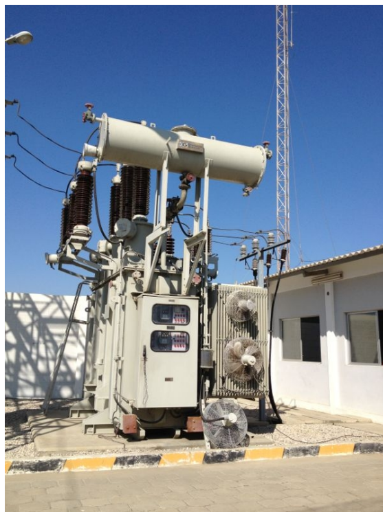
Fig 1.5 Transformador de Fuerza S/E Carolina
