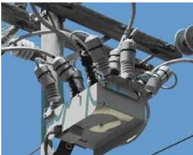
Fig 4. 6Reconectador Trifásico en Poste
