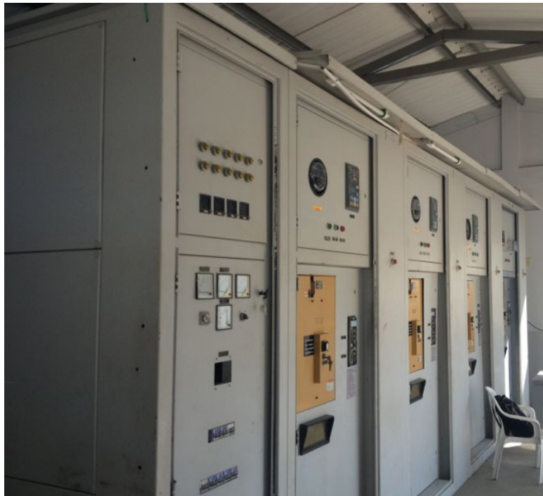
Fig 1.6 Sala de Tableros de 13.8 kV S/E Carolina
