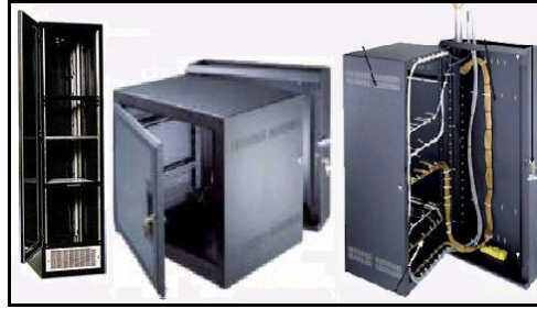
Figura 2.36 Rack de comunicación
