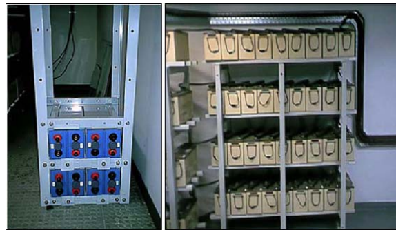
Figura 2.25 Banco de baterías
