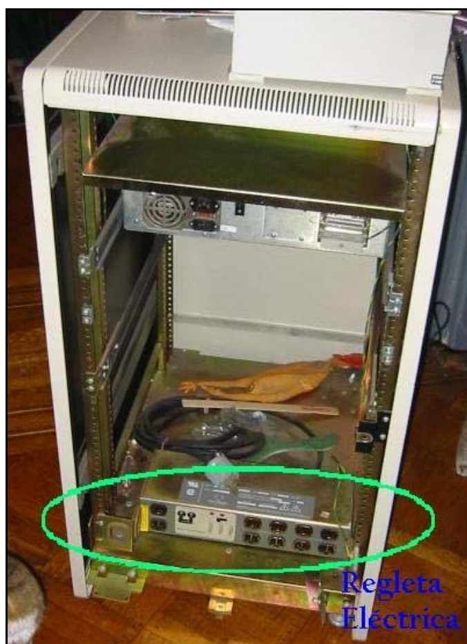
Figura 2.14 Rack con regleta eléctrica montada
