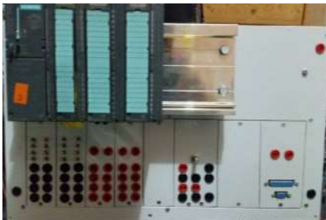
Figura 4.8: Tablero de control.
