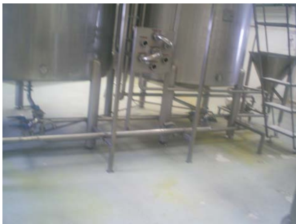
Fig. 2.19 Foto líneas de distribución ciclo III
