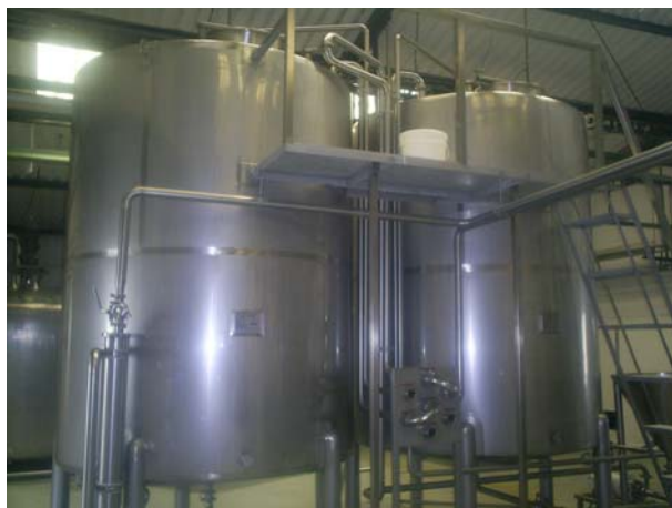
Fig. 2.17 Foto tanques de mezcla ciclo 3
