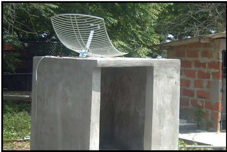
Fig 4.12 Cabina de Equipos
