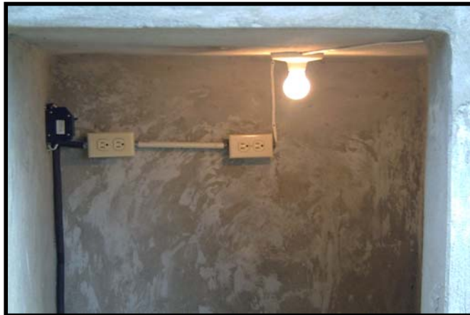
Fig 4.16 Breaker, tomacorriente y foco de la cabina de equipos
