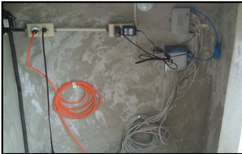
Fig 4.24 Equipos dentro de la Cabina
