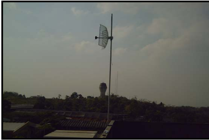
Fig 4.31 Antena en el edificio de Tecnología
