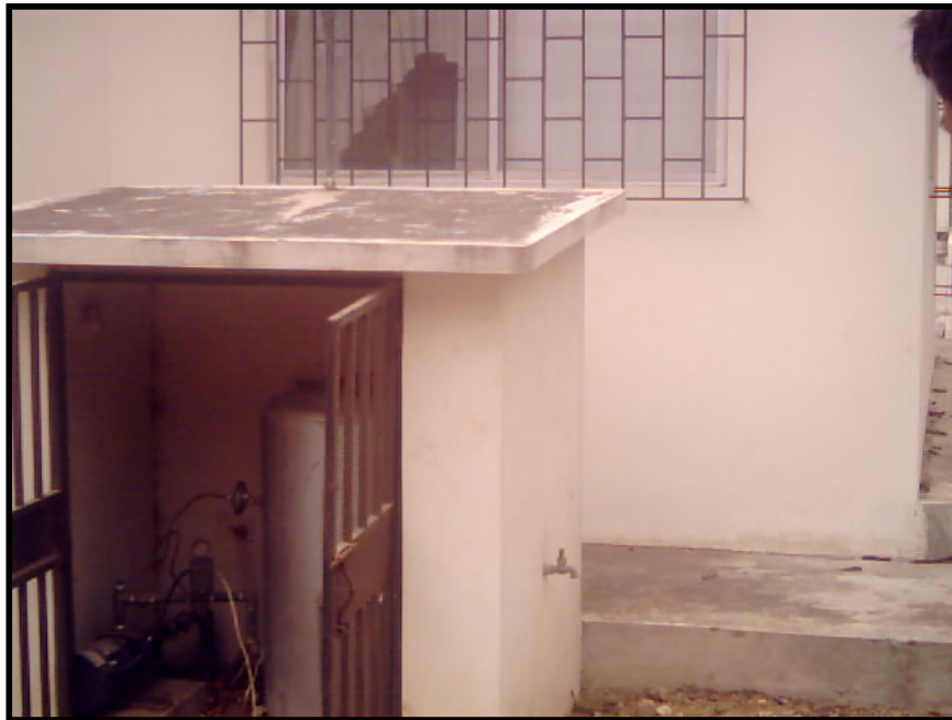
Fig. 2.12 Cabina de Cemento
