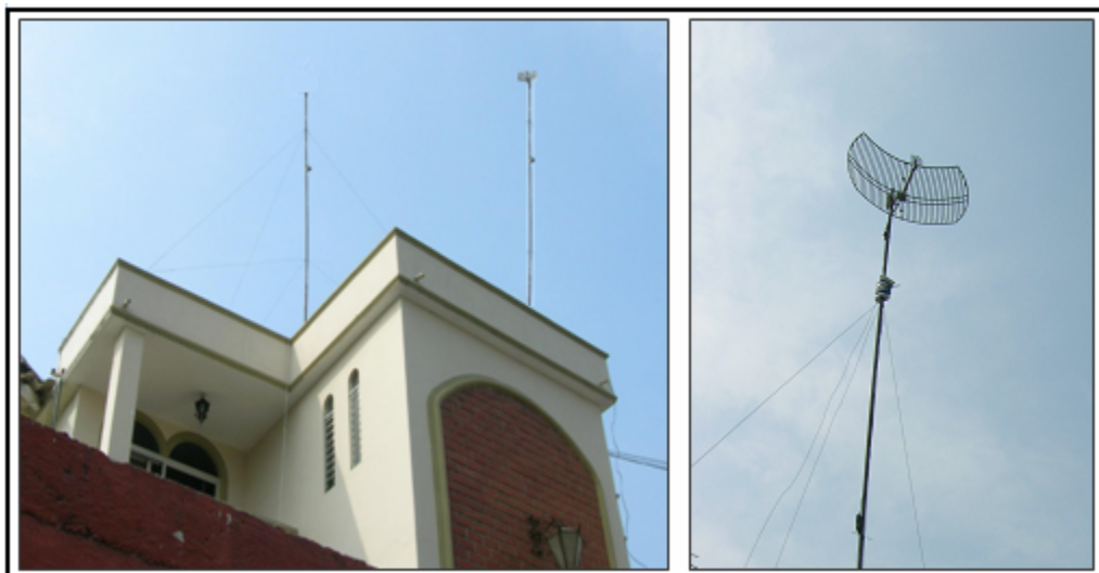
Figura 4.2 Antenas instaladas en sucursal
