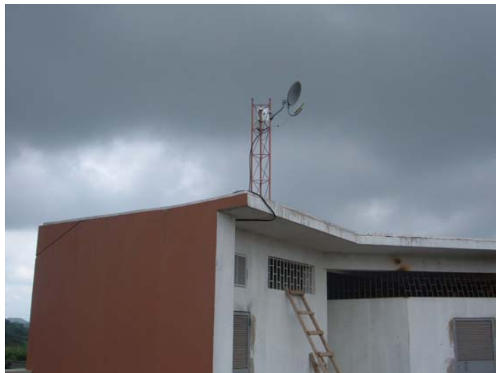
Figura 3.3. Vista frontal del enlace radial actual del Hospital
