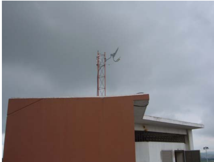
Figura 3.2. Vista lateral de la antena del enlace radial actual al Hospital
