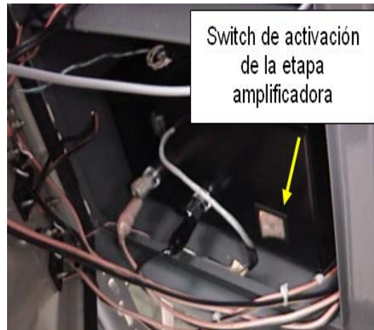
FIGURA 4.3.4.1.2 FUENTE DE ACTIVACIÓN DEL SISTEMA.
