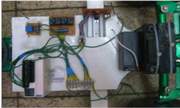
Vista de cerca del sistema de control del bus
