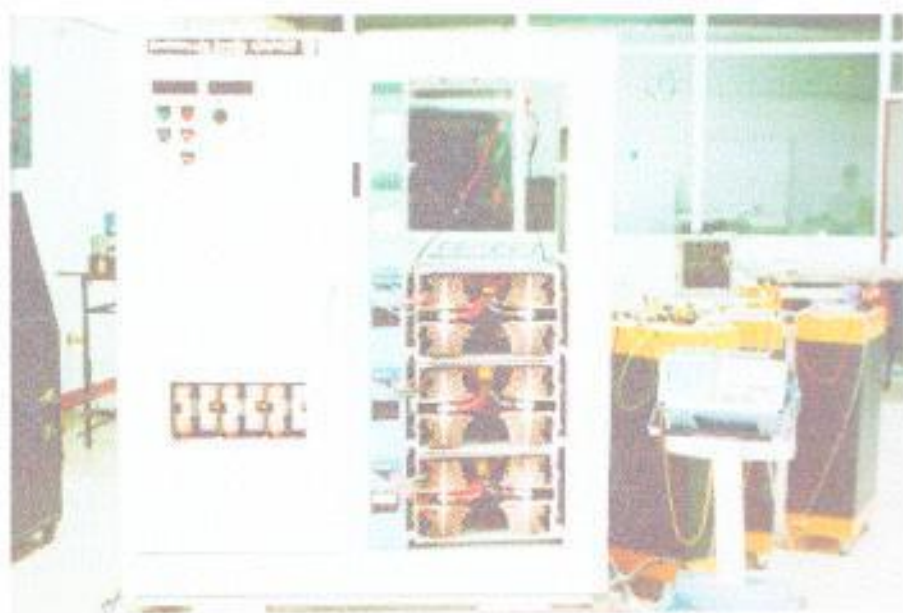
Módulo convertidor y equipo para las calibraciones
