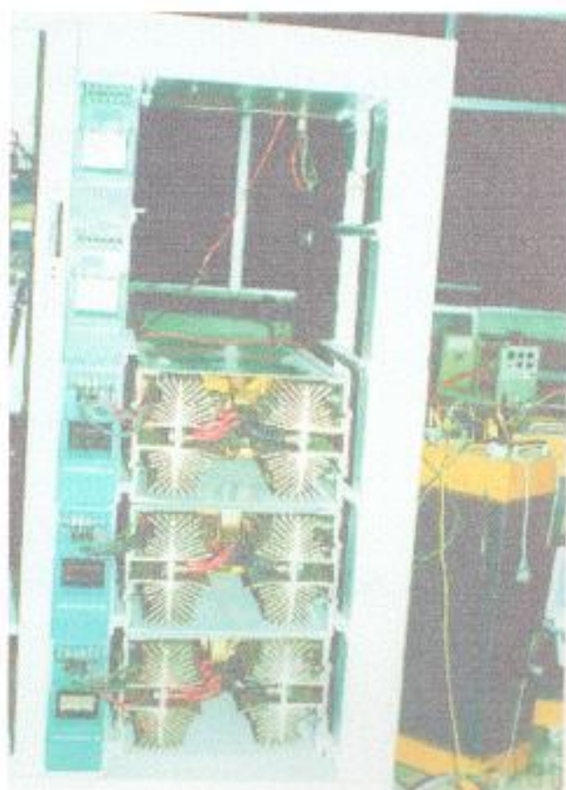
Módulos de Poder; vista de los disipadores de los diodos
