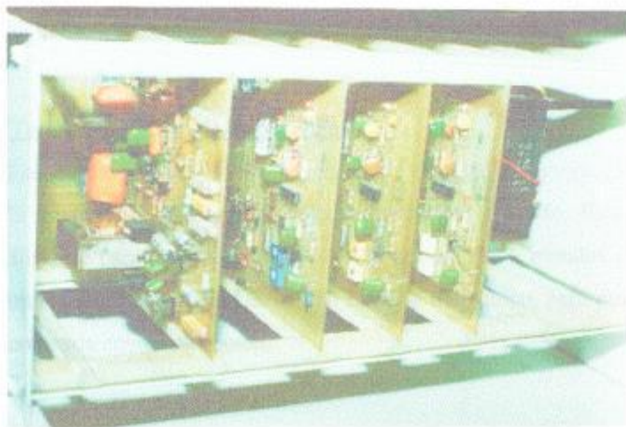
Módulo de control electrónico del convertidor: Tarjeta de control electrónico (izq.) y tres tarjetas de impulsión de compuerta
