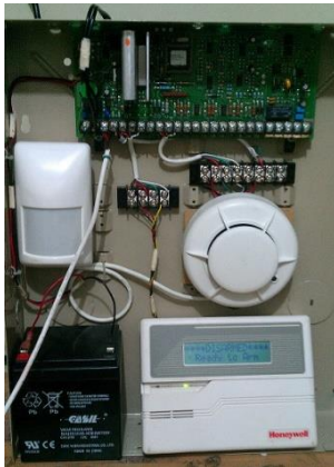
Figura 3.1: Vista interna del panel y detectores a ser usados.
