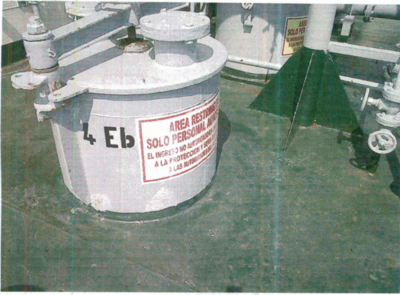
7.- Área de tanques de carga con su letrero distintivo
