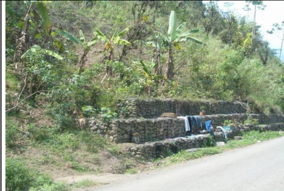
Fotografía 6. Muro de gaviones estructurado en la margen izquierda de la vía Caluma San Vicente de Pacana, para estabilización del deslizamiento ocurrido a raíz del corte de la ladera.
