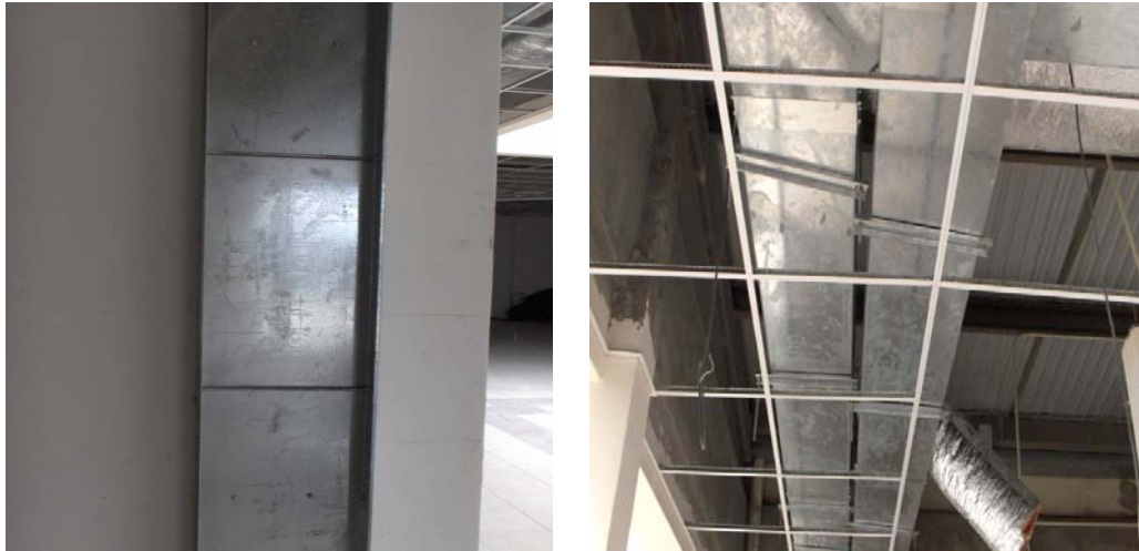
FIGURA 2.10 CANALETA PARA CABLES DE DATOS
