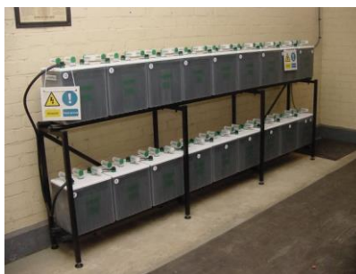
Figura 2.12: Sistema de baterías [7]
