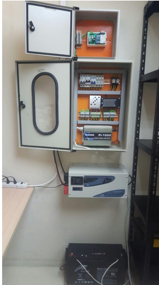
Figura 3.23: Implementación del sistema fotovoltaico
