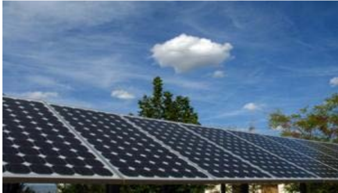
Figura 1.1 Arreglo de paneles fotovoltaicos
