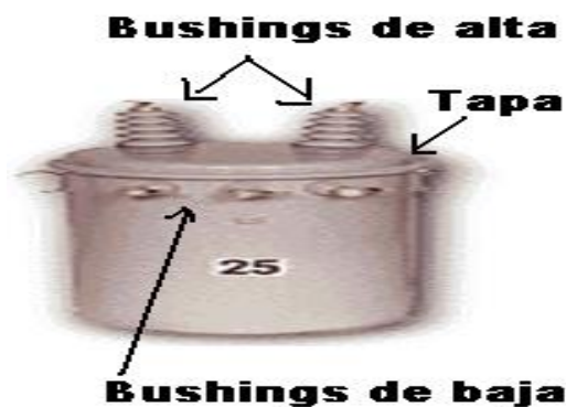
Figura 13: Vista frontal del tanque de un Transformador de distribución.
