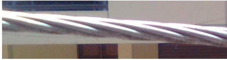
Figura 37: Conductor AAC foto tomada de redes de baja tensión de la ciudad de Babahoyo.
