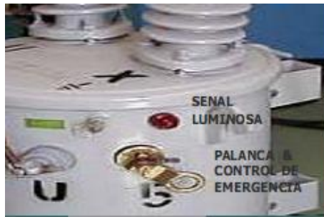
Figura 17: Lámpara de señalización de Transformador autoprotegido General Electric.
