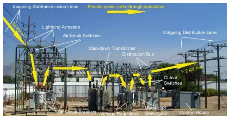
Figura 84: Vista de una subestacion clasica tomado de www. Electric Power e Tool. Com.
