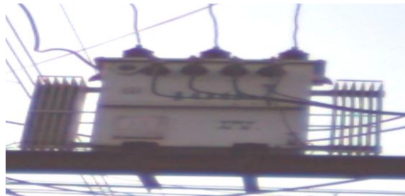
Figura 19: La fotografía tomada en las redes de distribución del centro de Babahoyo, muestra un Transformador de 100 Kva trifásico.
