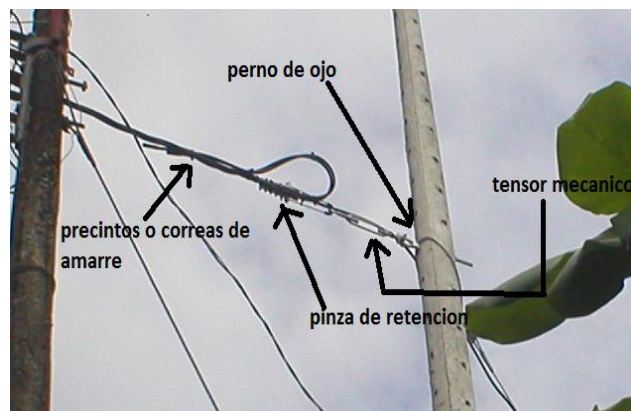
Figura 46: Estructura preensamblada en baja tensión con sus respectivos elementos.
