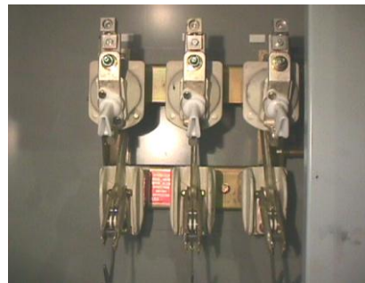
Figura 2. 4 Seccionador Vista frontal.
