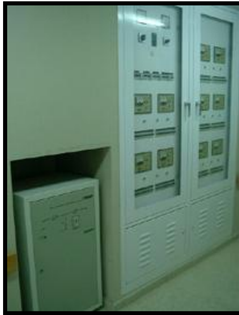
Figura 2.3.- Panel de detección de interrupción de la toma a tierra.
