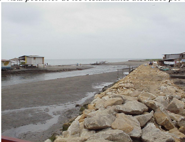
Foto 20 Vista posterior de los restaurantes afectados por el oleaje
