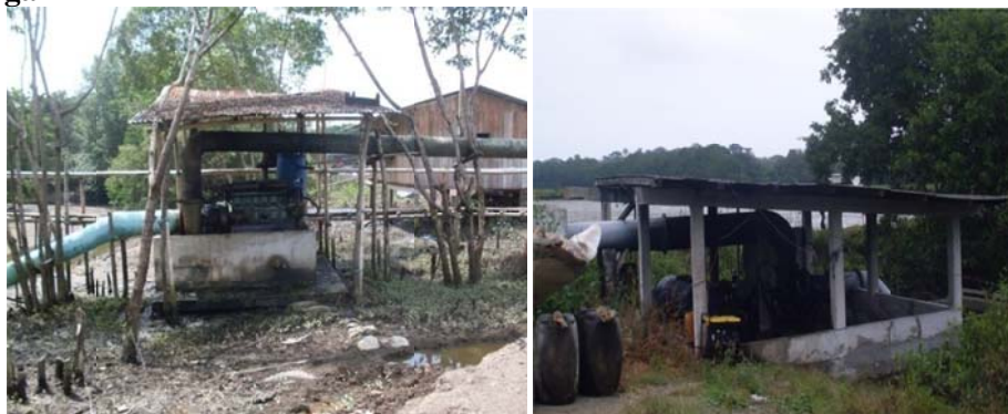
Figura # 20. Estación de bombeo de Camaronera Alcívar y Camaronera Alfa & Omega
