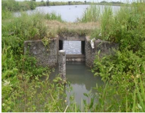
Figura # 21. Compuerta con el monje hacia el lado del canal reservorio. Camaronera Puimar
