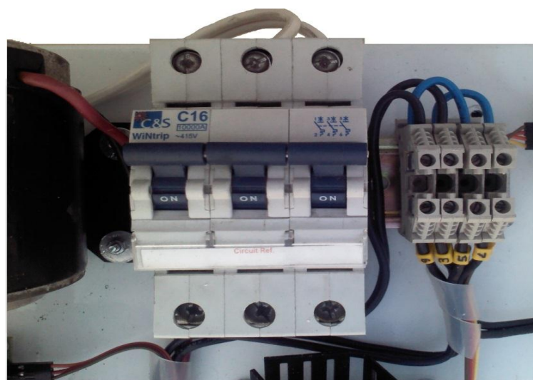
FIGURA 3.4: IMPLEMENTACIÓN DE PROTECCIÓN ELÉCTRICA
