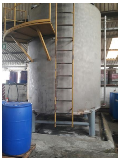
Figura 12 Tanques sin rótulos y mal posicionados
