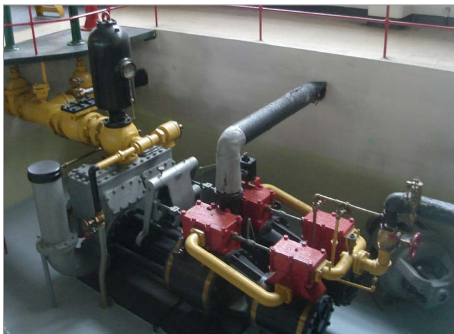
Figura N° 20 Bombas Donkers Fuente: Elaboración Propia
