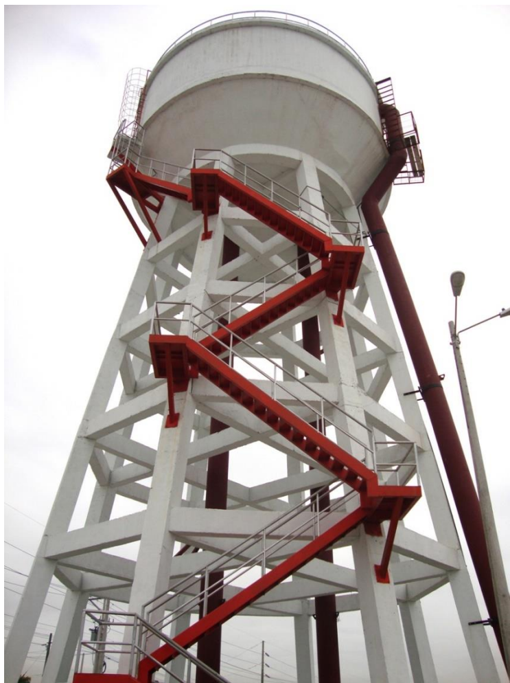
Figura 2. 6 Tanque elevado ubicado junto a reservorio El Recreo
