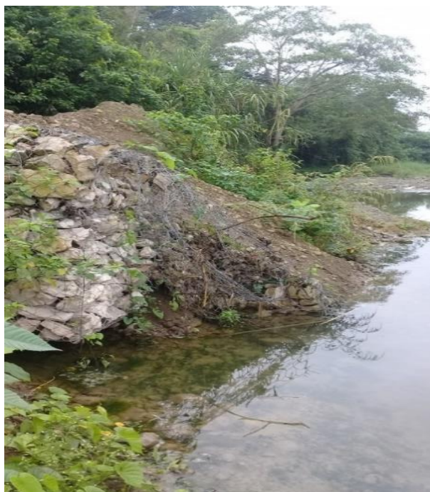
Figura 3. 2 Antiguo tape de gaviones, destruido por efecto de la corriente del río.
