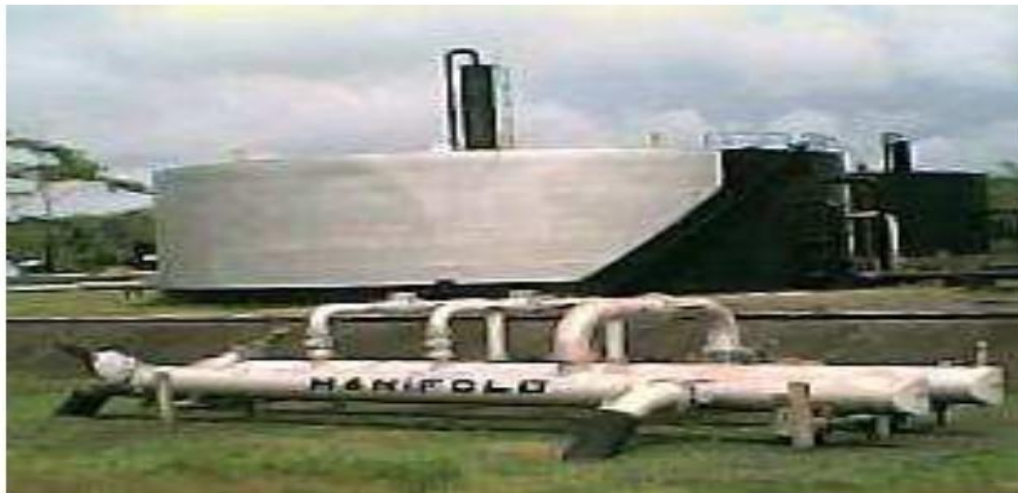
Figura 1.6 Tanque de reposo
