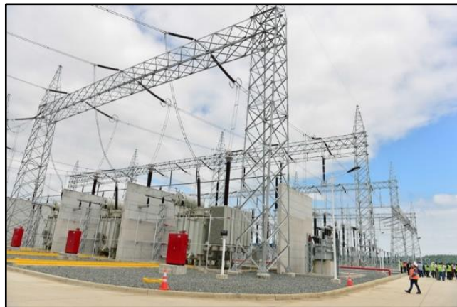
Figura 2.16 Subestación eléctrica Chorrillos.
