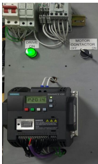
Figura 3.1. Panel de Variador Siemens V-20
