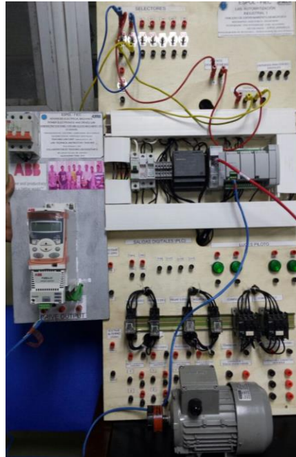
Figura 3.2. Conexión entre Micro850 y ACS355
