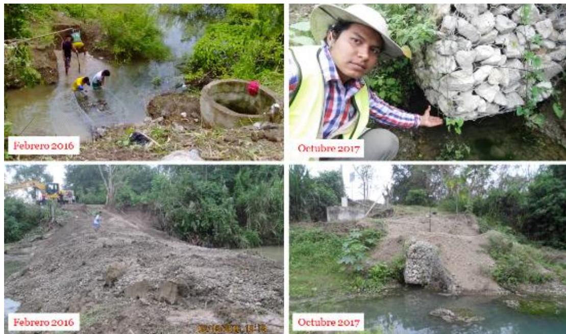
Figura 0.5. Dique artesanal fallado durante la época invernal.
