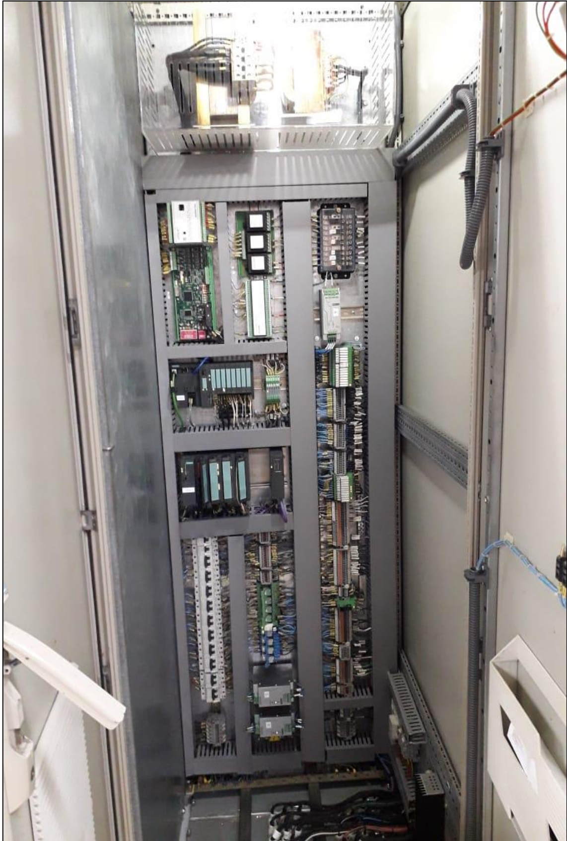
Figura apéndice 17: Gabinete de las tarjetas del regulador de velocidad
