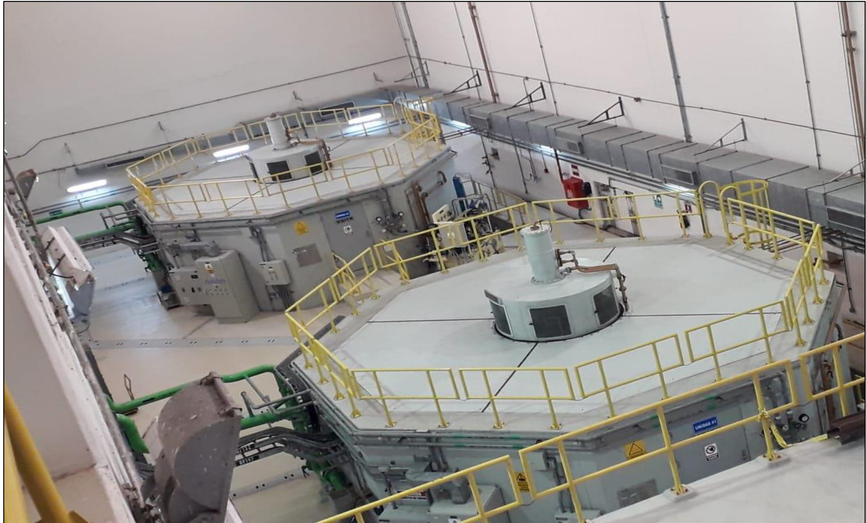
Figura apéndice 18: Unidades de Generación en casa de máquinas central Baba
