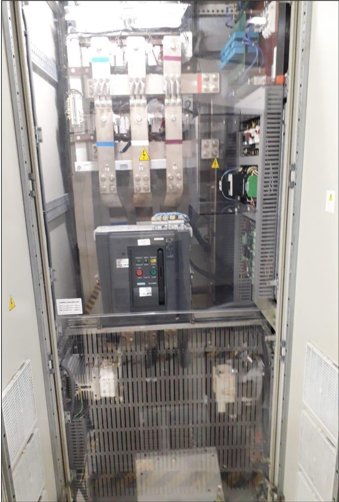
Figura apéndice 16: Gabinete del Puente de Tiristores
