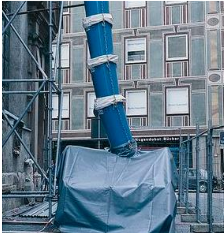
Figura 3.72 Ducto y contenedor para residuos sólidos
