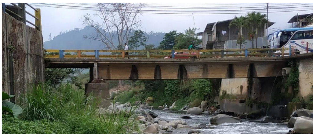
Figura 1.1 Puente vehicular sobre río Caluma, en dirección aguas abajo. Se evidencia una cavidad debajo del apoyo y los grandes bloques que movilizan los caudales.
