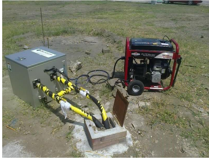
Figura 3.6. Sistema Instalado, medición P1 Espol.
