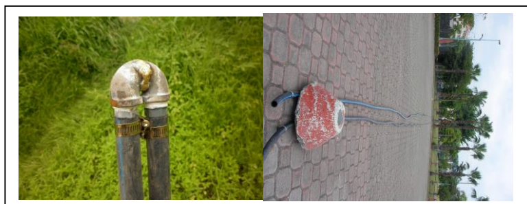
Figura 3.4. Codo metálico y Tubería de polietileno de alta densidad.
