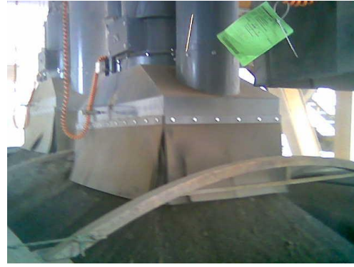
Proceso de Carga de Clinker
