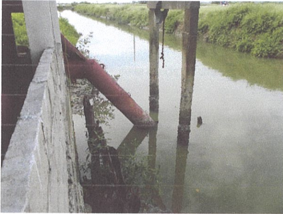
Foto 3. Inspección inicial, ausencia de malla protectora en la toma de agua de la estación de bombeo.
