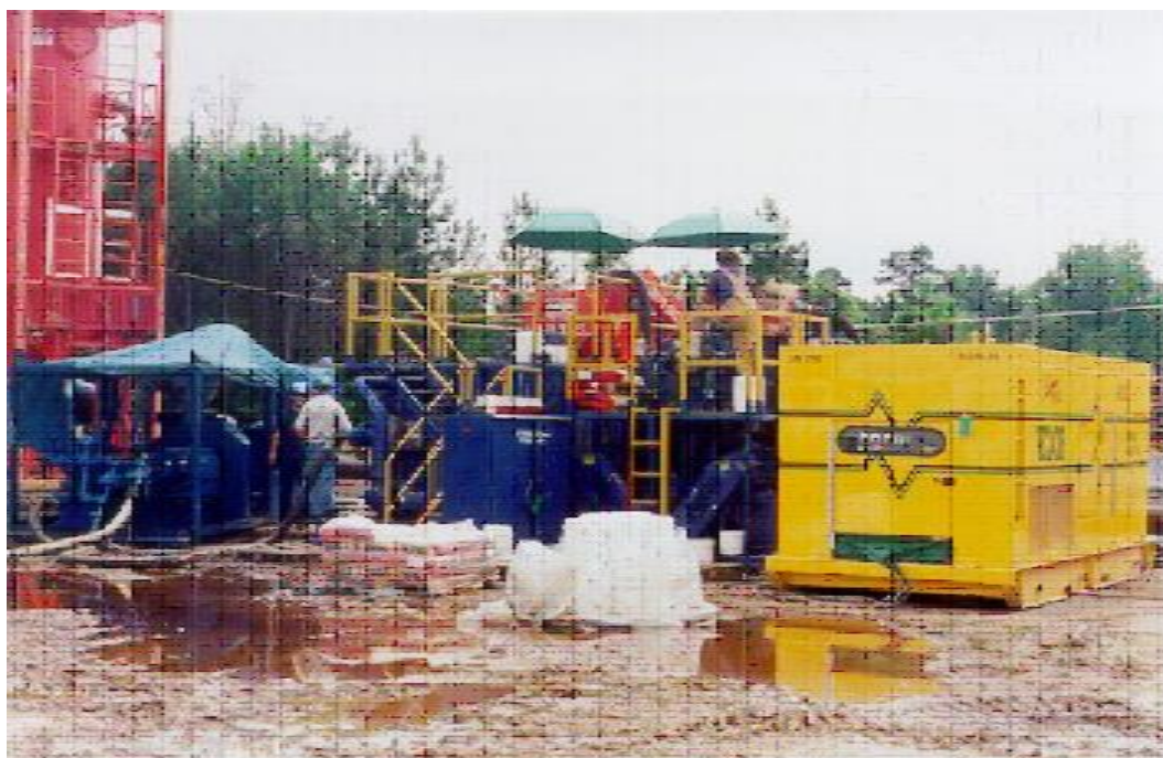
Figura 4.11. Espacio para el equipo de re-inyección.
