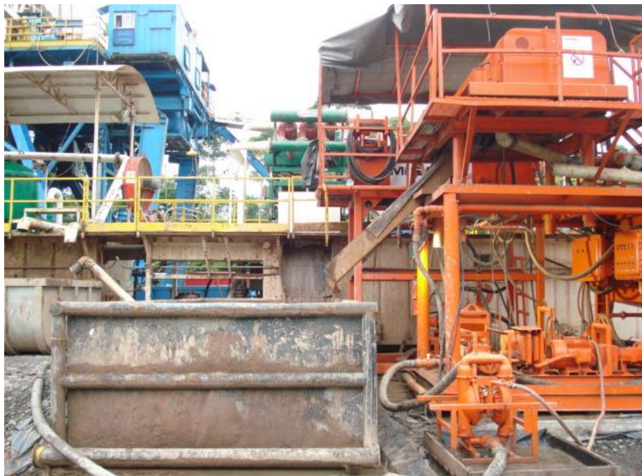
Grafico 3.10. Tanque de almacenamiento en el proceso de dewatering.
