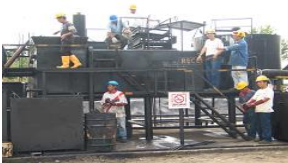
Figura 4.4. Equipo de tratamiento y recuperación de crudo.
