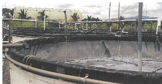
Fig. 11. Tuberías de aire y de agua.
