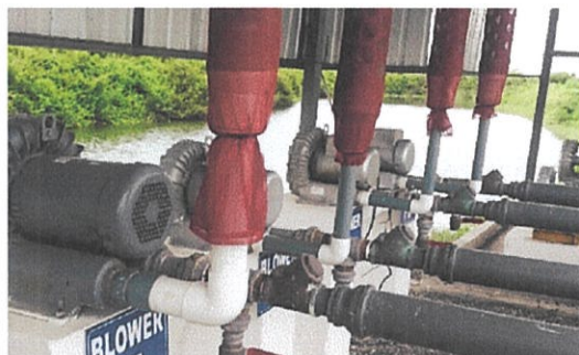
Fig. 10. Blowers de 5 HP.
