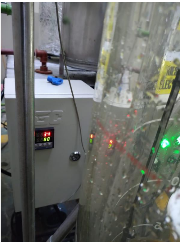
Figura 23. Controlador Instalado con set point de 80°C
