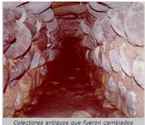
Colectores antiguos que fueron cambiados
