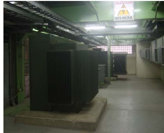
Figura 2.1 Vista del centro de transformación
