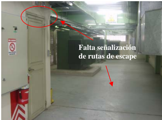
Figura 2.2 Ausencia de señalización
