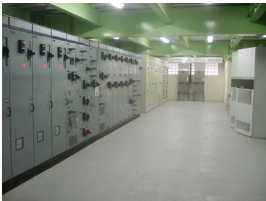
Figura 2.3 Vista del área del los CCM
