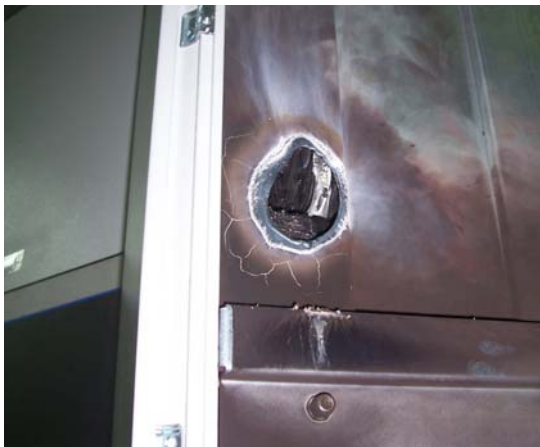
Figura 3. Resultado de cortocircuito y arco eléctrico
