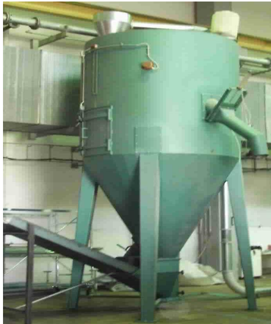
Figura 5: Silo de Almacenamiento
