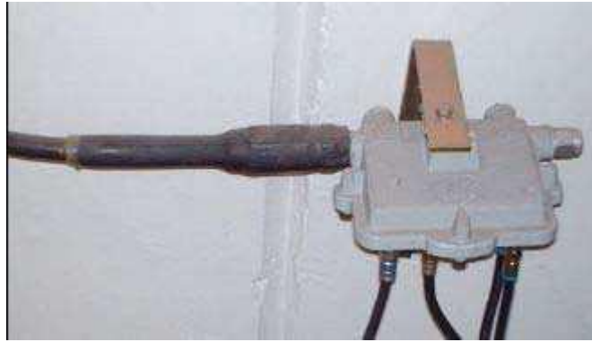
Figura 5-5: Elemento pasivo TAP
