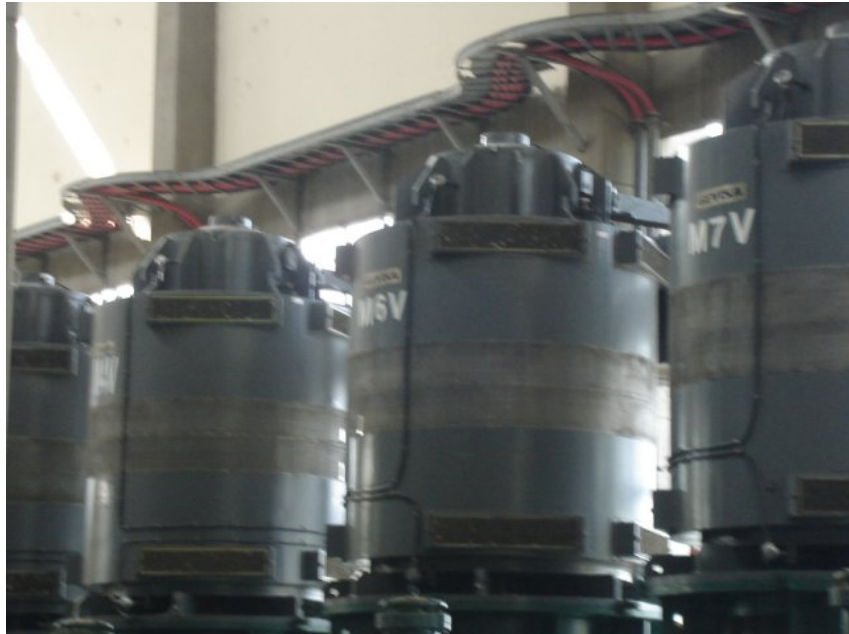
Figura 1.1. Motores trifásicos de 3000HP, 13800V
