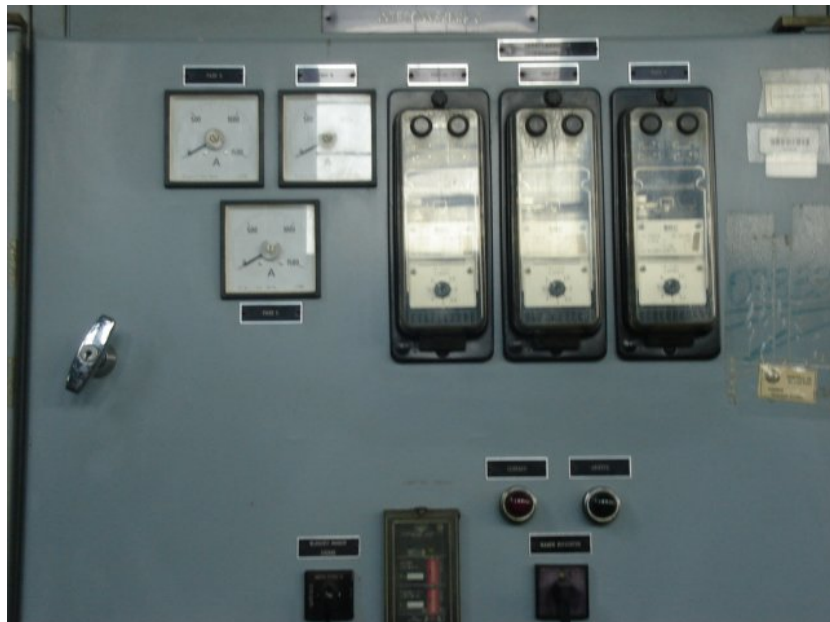
Figura 1.4. Protecciones de los Motores trifásicos de 1250 HP, 4160 V, 125 A
