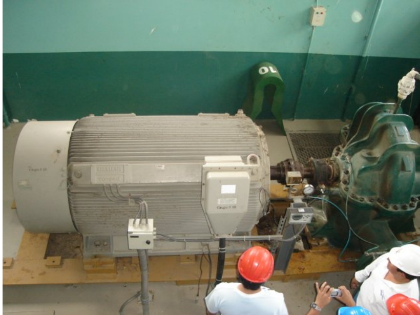
Figura 1.3. Motores trifásicos de 1250 HP, 4160 V, 125 A
