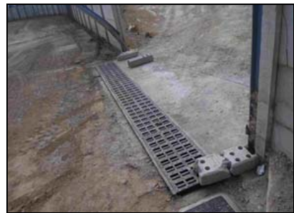
Figura N° 2.33 Rejilla para evacuación de agua
