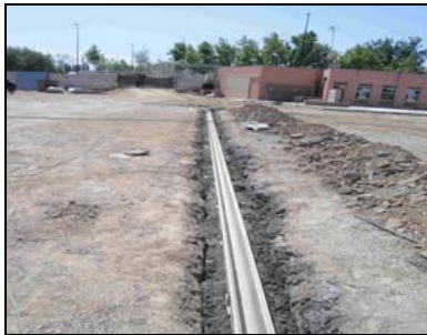
Figura N° 2.32 Canales de drenaje
