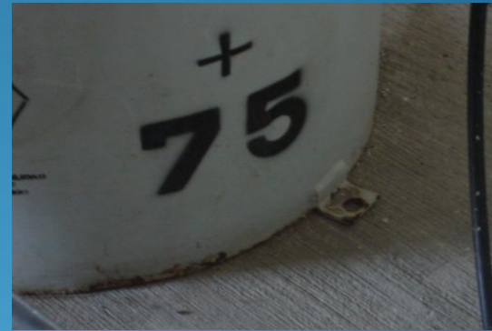
Corrosión en base de Transformador
