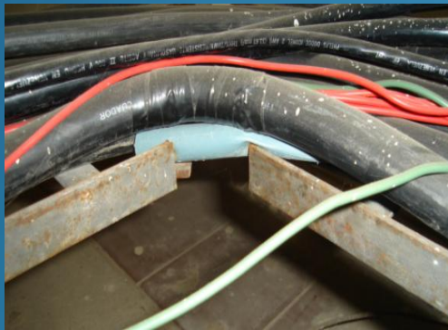
Corrosión de soporte en “C/T 23”
