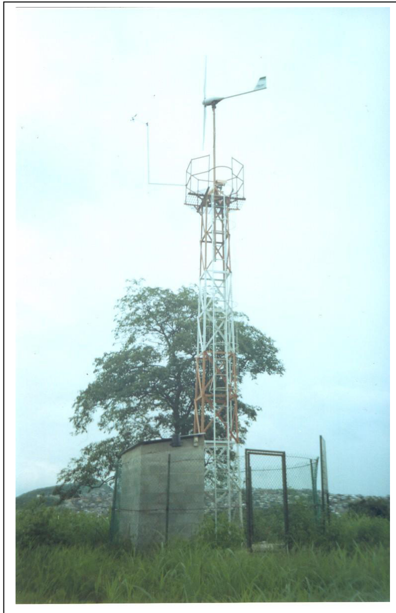
Figura 2.17: Generador eólico ubicado en el CENAE.
