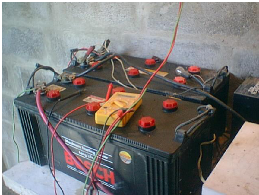
Figura 4.2: Baterías en la estación del GENAF
