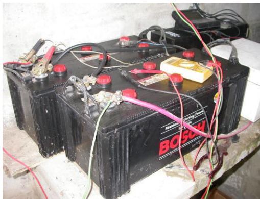
Figura 3.18: Baterías utilizadas en la estación
