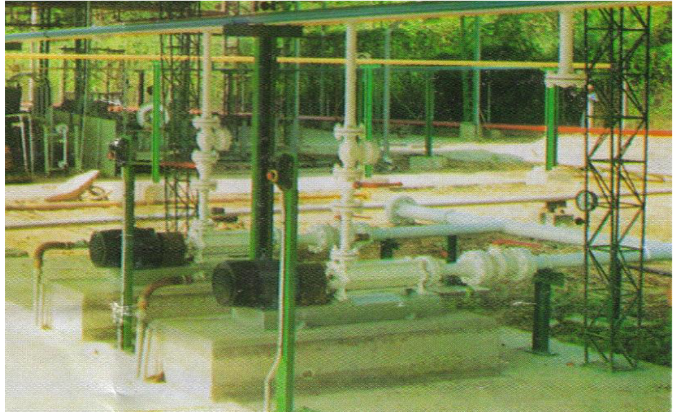
FIGURA 1.3. BOMBAS PARA EL TRASIEGO DEL GLP
