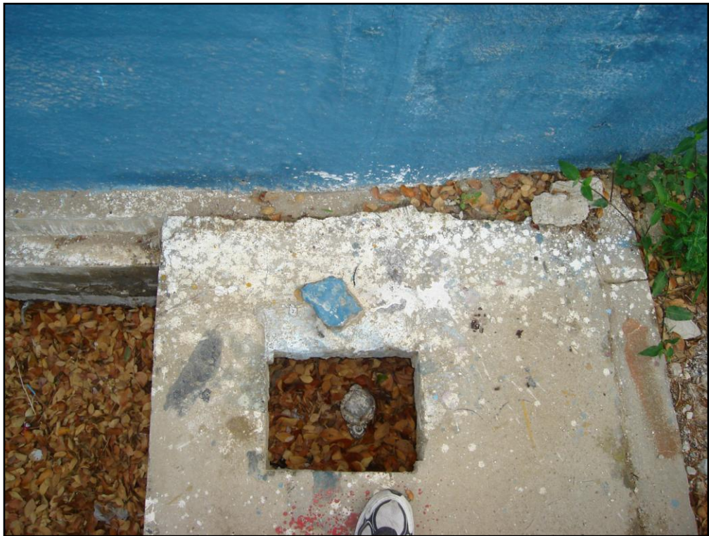
Figura. 3.6 VALVULA DE APERTURA PARA RECEPCION DE AGUA DEL CIRCUITO SUBMARINO (MAR-TIERRA)
