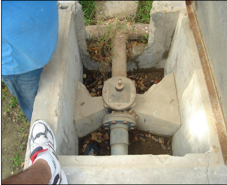
Figura. 3.20 VALVULA DE SUCCION HACIA EL CUARTO DE BOMBAS
