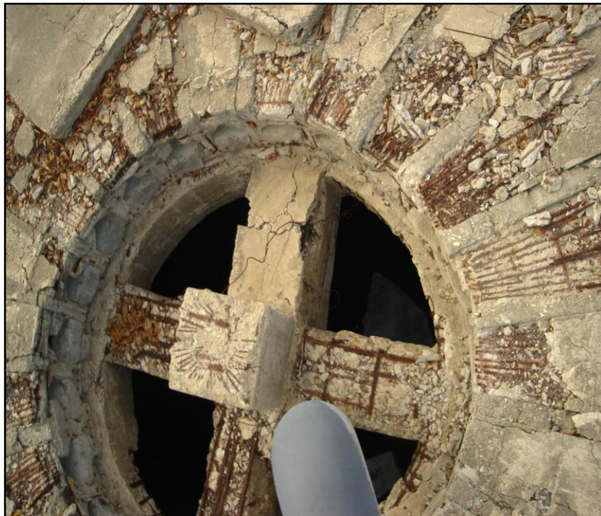
Figura. 3.12 ESTADO DE LAS TAPAS DE INGRESO DE AGUA A LOSTANQUES CIRCULARES DE CONCRETO (VISTA SUPERIOR)
