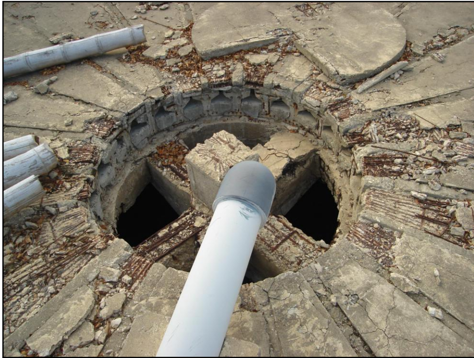
Figura. 3.12 ESTADO DE LAS TAPAS DE INGRESO DE AGUA A LOS TANQUES CIRCULARES DE CONCRETO (VISTA SUPERIOR)
