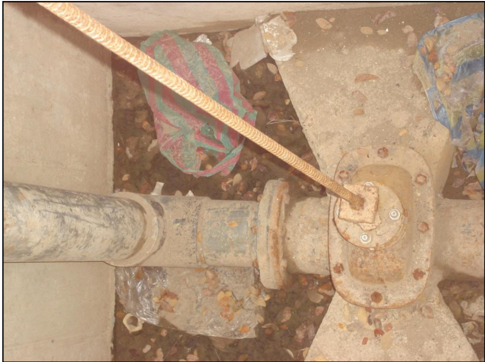
Figura. 3.7 VALVULA DE COMPUERTA DE PASO DE AGUA DESDE EL INGRESO A LA BASE HASTA LA CISTERNA PRINCIPAL
