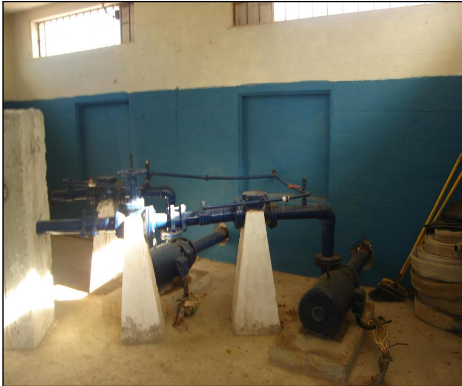
Figura. 3.18 VISTA INTERIOR DEL CUARTO DE BOMBAS
