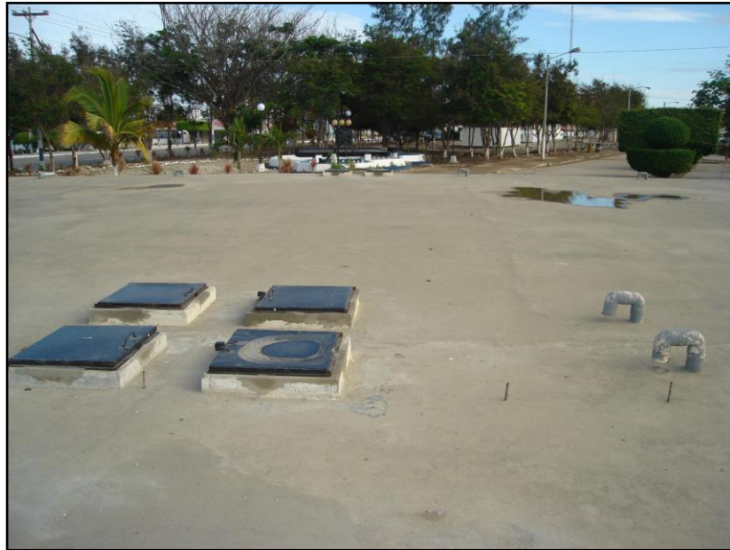
Figura. 3.2 TAPAS DE SECCIONAMIENTO DE AGUA DE LA CISTERNA PRINCIPAL
