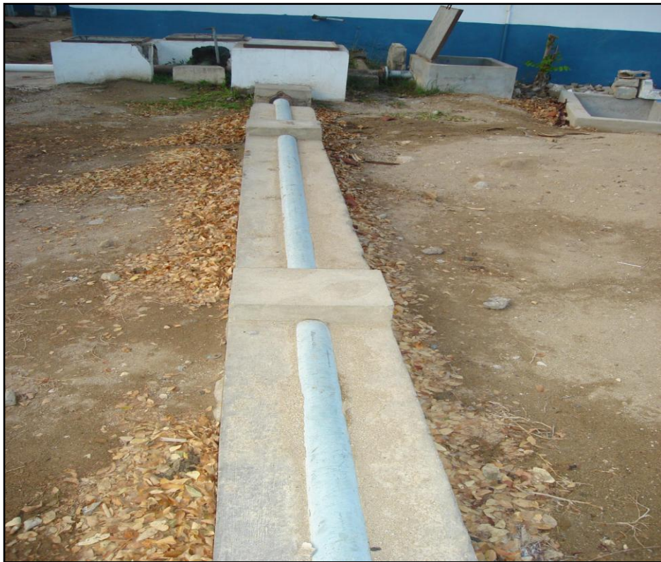
Figura. 3.14 TUBERIA DE PVC DE 4 PULGADAS A LA SALIDA DE LA CISTERNA HACIA EL CUARTO DE BOMBAS
