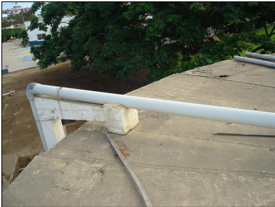
Figura. 3.11 TUBERIA DE PVC DE INGRESO A LOS TANQUES CIRCULARES DE CONCRETO
