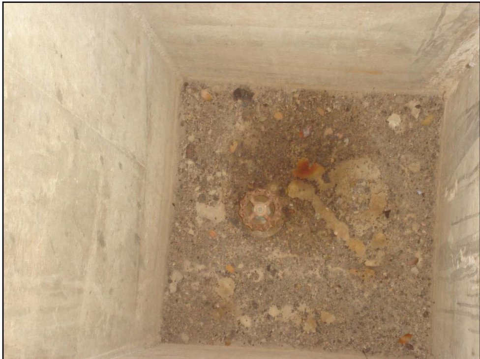
Figura. 3.5 VALVULA DE COMPUERTA PARA SECCIONAMIENTO DE AGUA EN CISTERNA PRINCIPAL
