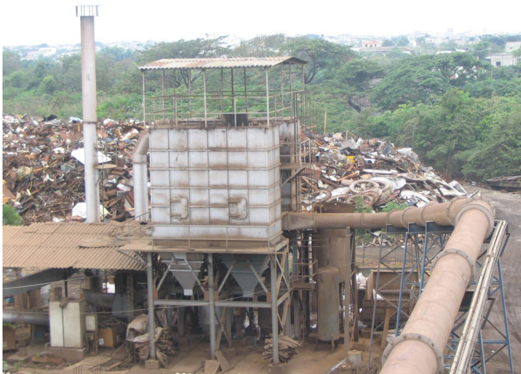
CAMARAS DE FILTROS
